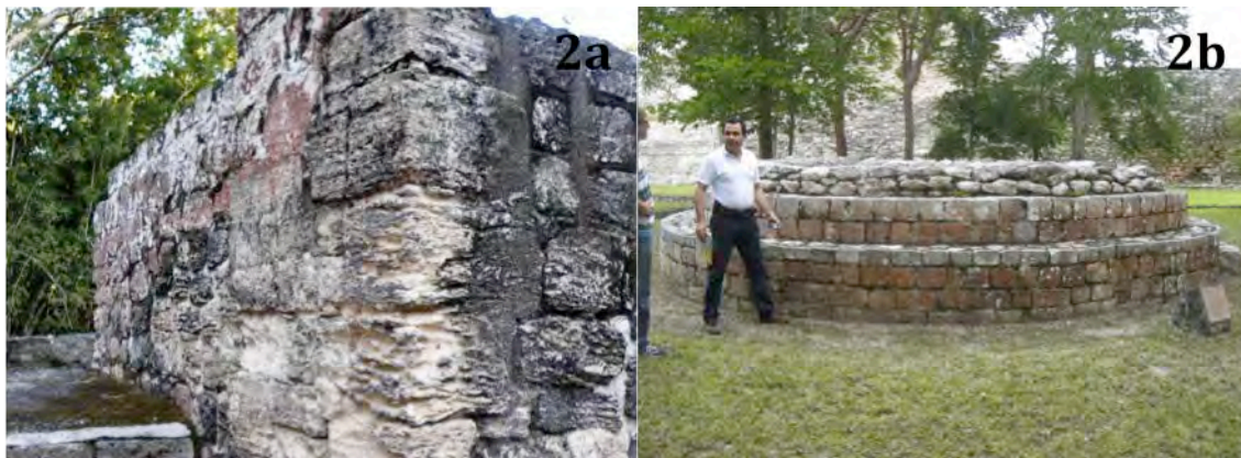
Figura 2a. Muro norte de la estructura I del sitio arqueológico de Chicanná, donde se evidencia la presencia de signos de deterioro por disolución (esquina del muro) y escaso desarrollo microbiano. Fig. 2b. Colonización masiva de biopelículas fototróficas dominados por alga Trentepohlia spp., cuya coloración rojiza se debe a la acumulación de carotenoides fotoprotectores.
