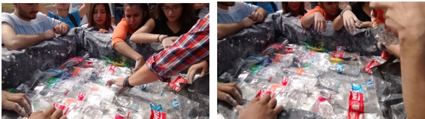
Figura 13.- Proceso de colocación de botellas pet de 600 ml en sus diferentes etapas realizados por alumnos de la escuela de arquitectura.
