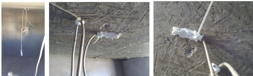
Figura 11. Sensores instalados para las mediciones internas
