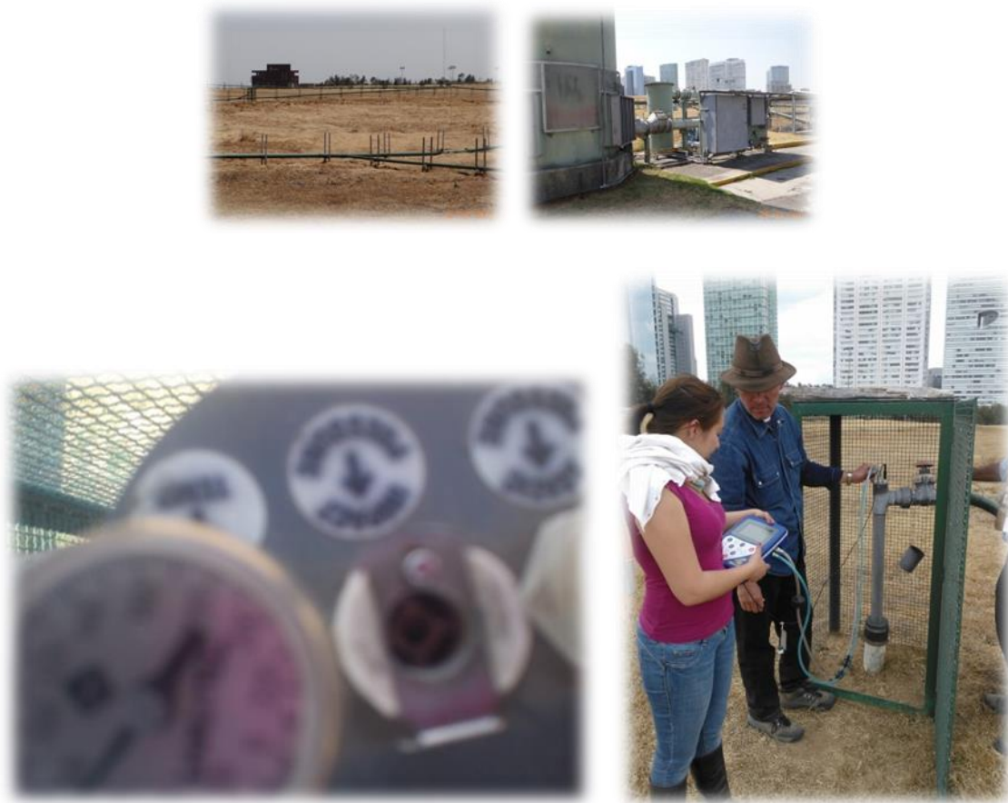
Figura 8. Red de extracción del biogás mediante 112 pozos en el SDF-PM. Se muestra una fotografía del cabezal.
